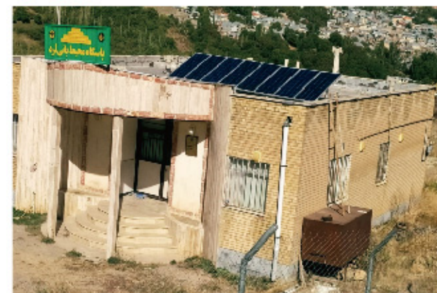
太阳能光伏发电系统安装在伊朗环境保护工作站。
